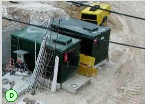
Moderni serbatoi di gasolio, in contenitore a prova di perdite
