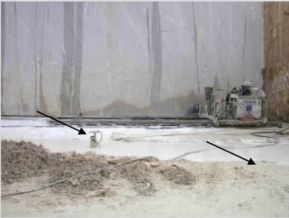
Pompa sommersa e cordolo inadeguato (frecce)
