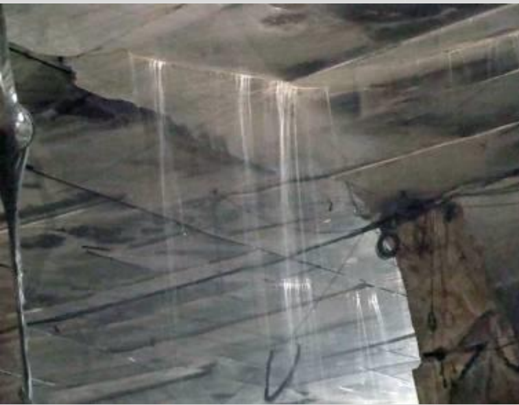
Cava in galleria: pioggia dalle venature idriche intercettate sul soffitto
