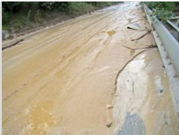
Fanghi su via comunale Piastra-Ravaccione dopo pioggia
