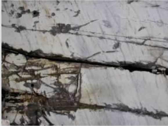
Frattura beante (via d'infiltrazione)
