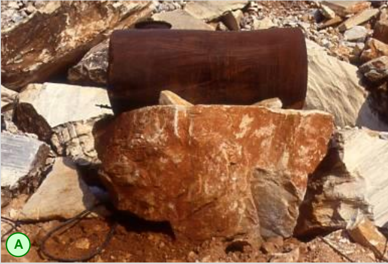
Serbatoio all'aperto, terreno intriso di gasolio
